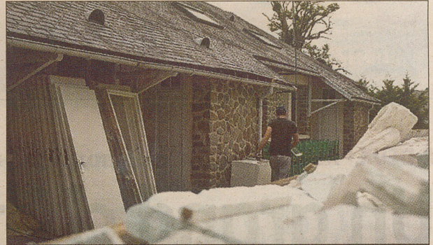
MEUBLÉS. En quelques semaines, les végétaux envahissants, qui avaient atteint les toits pour certains, ont été déblayés.
